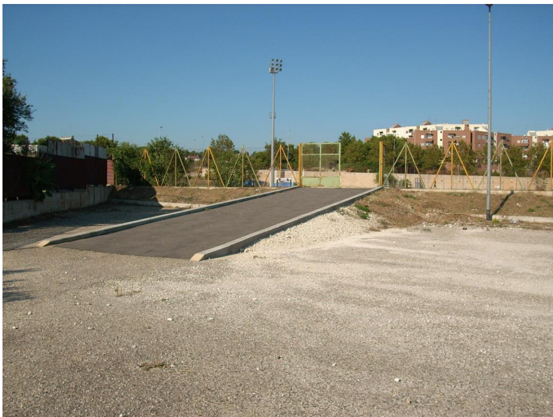
La rampa di collegamento tra lo spazio sportivo principale (calcio ed atletica leggera) e l'area annessa all'impianto con ingresso da Via Strauss
