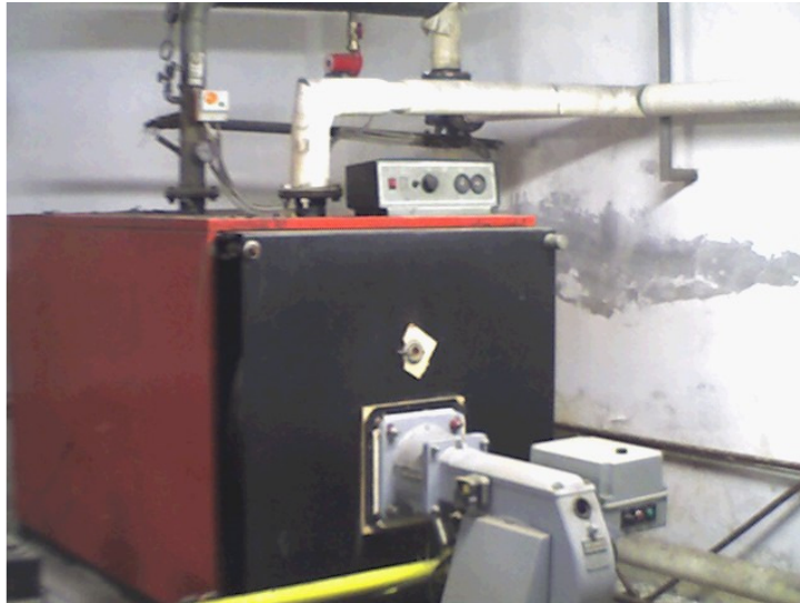
Foto 9: Locale centrale termica - Caldaia esistente
