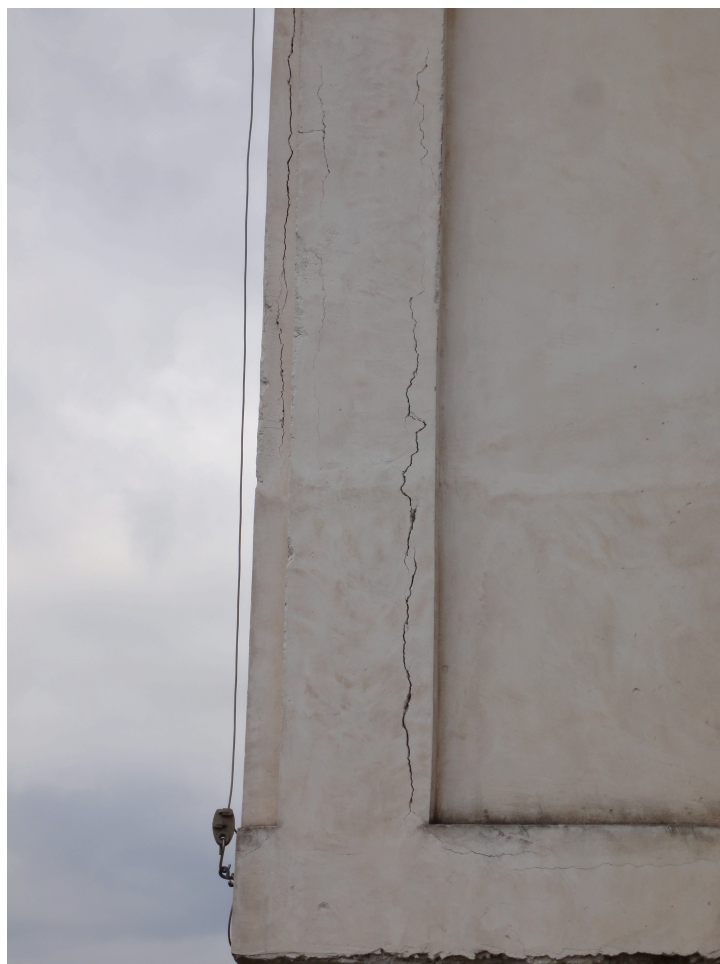
Foto 4: Evidente quadro fessurativo pilastro
