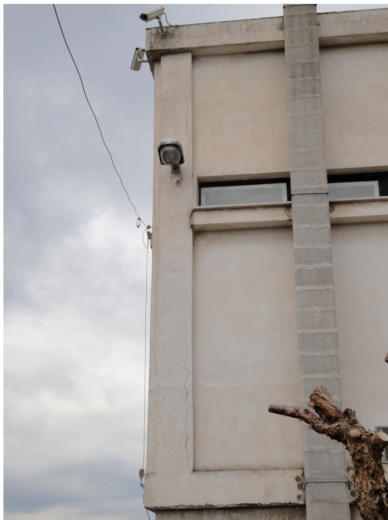
Foto 2: Telaio in calcestruzzo e relativo quadro fessurativo
